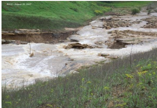
Bad Axe 12 Aux. Spillway Damage-Aug. 2007
