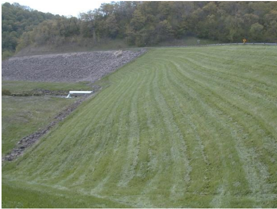
2:1 Embankment Mowing Bad Axe 12
